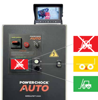
Steuerkasten im Inneren des Gebäudes
