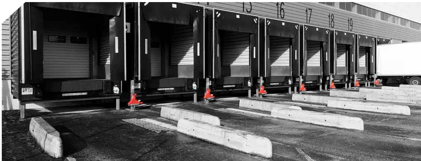
ID Logistics Châtres sécurise ses quais avec le système de retenue POWERCHOCK 3.
